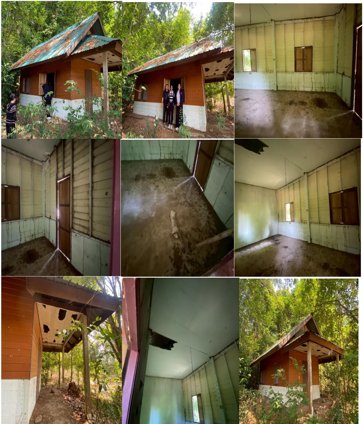
อาคารหมายเลข ๓๘ สำนักงานโครงการยางพาราเก่า จำนวน ๑ หลัง
